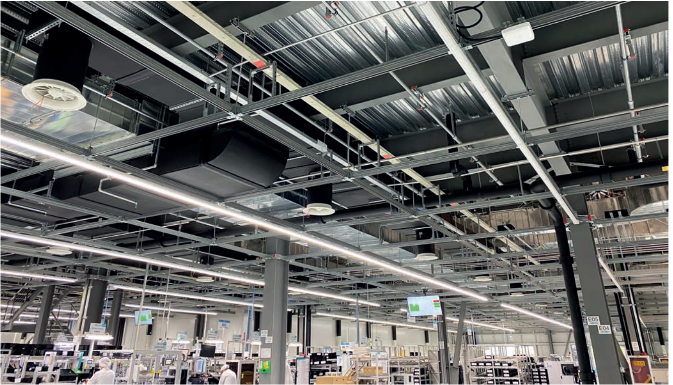
Die Versorgungsleitungen sind komplett an der Decke der Werkhalle. Das hat es ermöglicht, eine Fußbodenheizung zu installieren.
